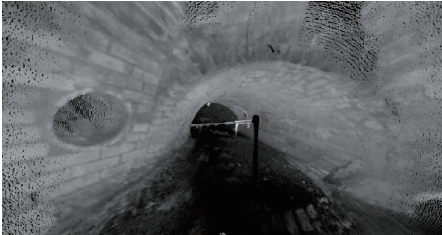
一副基于激光扫描器扫描数据的三维 AutoCAD 图像中，砖砌的下水道中的裂纹及其他区域清晰可见
