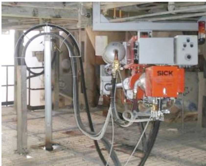
Abb. 31: Schlauchhalterung an einem Mast und auf dem Boden (Beispiel)
