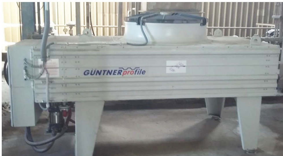
Abb. 40: Wasser-Wasser-Kühlgerät, komplett installiert
