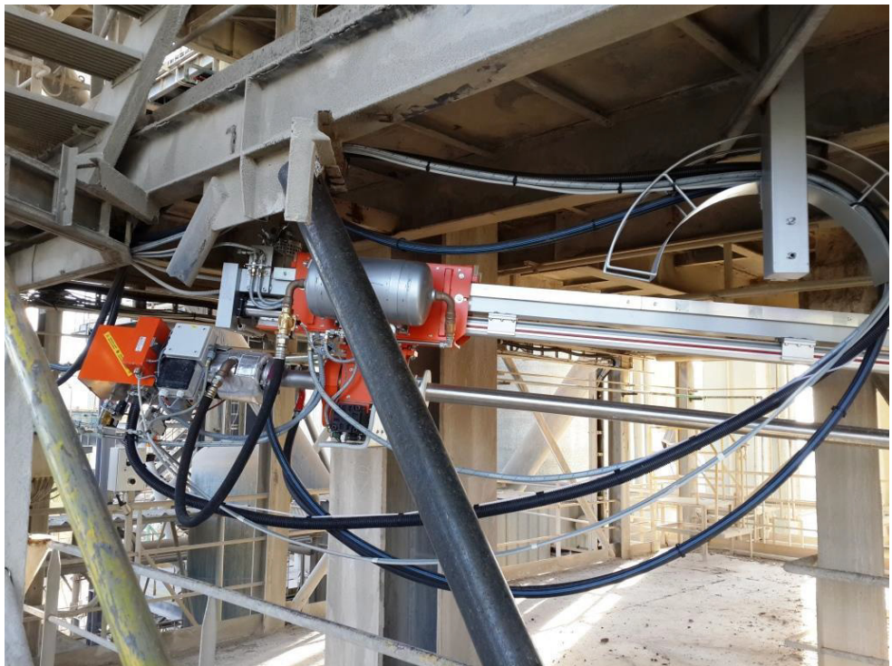
Abb. 37: Sonde mit vollständig installierter Kabel- und Schlauchvorrichtung (Beispiel)
